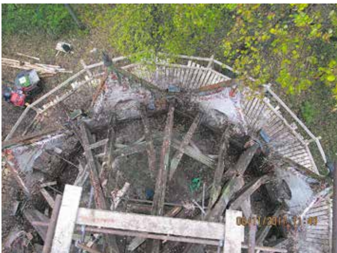
Fot. Blick auf den maroden Dachstuhl von oben beim Rückbau im November 2017 (Matthias Hohl)
