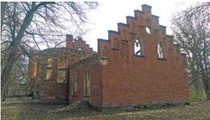
Fot. Das Herrenhaus in Prassen teilt das Schicksal zahlreicher deutschen Denkmäler in unserer Region. Es hat den letzten Weltkrieg gut überstanden, aber nicht die Wende. Einer seiner Eigentümer hat in den Wänden nach angeblich verstecktem Gold gebohrt. Dadurch hat er die Mauern zum Einsturz gebracht und natürlich keine Schätze gefunden.
